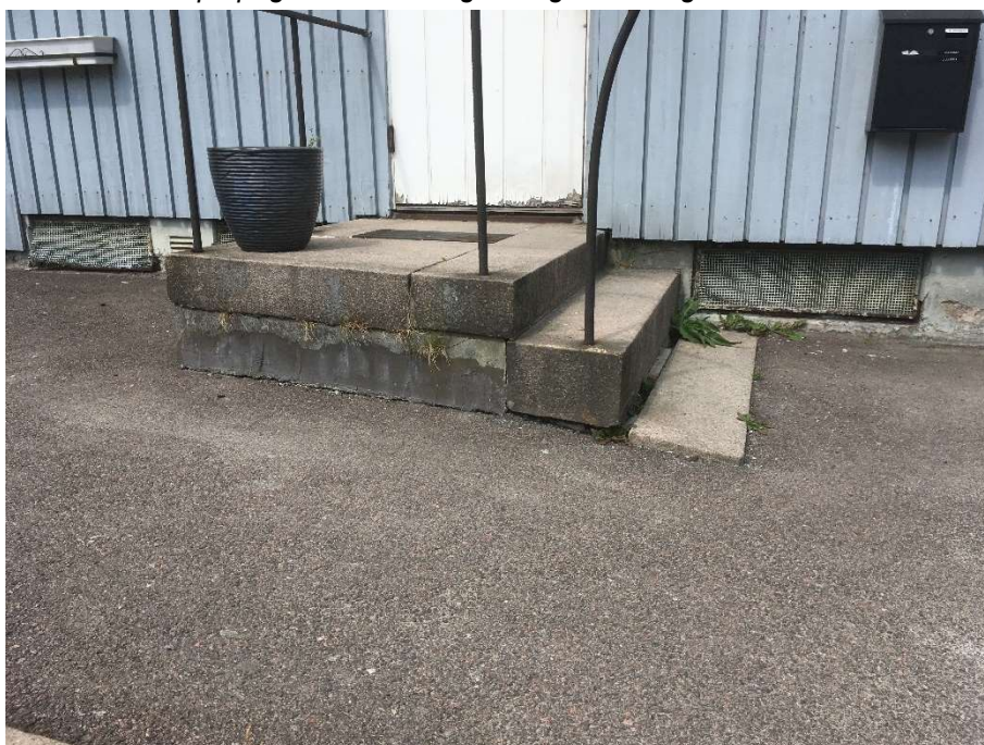
Bild 7. Tecken på pågående sättningar vid trappan.
