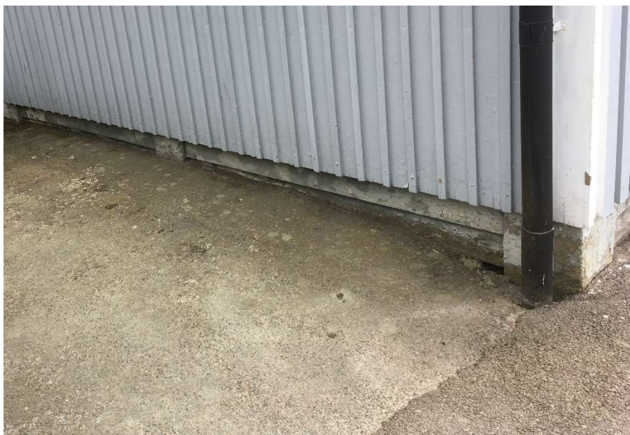
Bild 6. Tecken på pågående sättningar längs husets grund.
